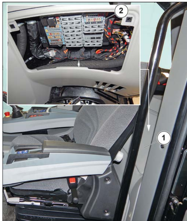
Figur 214: Sikring og relæ i førerhuset
