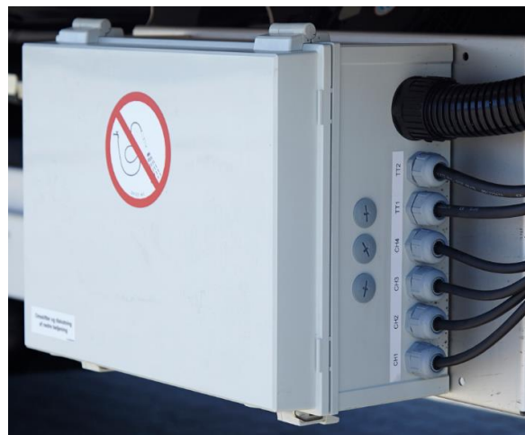
El-skab under chassis Fig. 4-5-1-A
